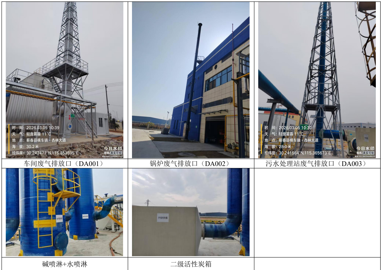
图 4.1-6 项目废气处理措施图
