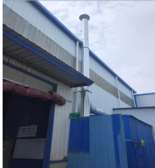
喷砂废气排气筒及标识牌
