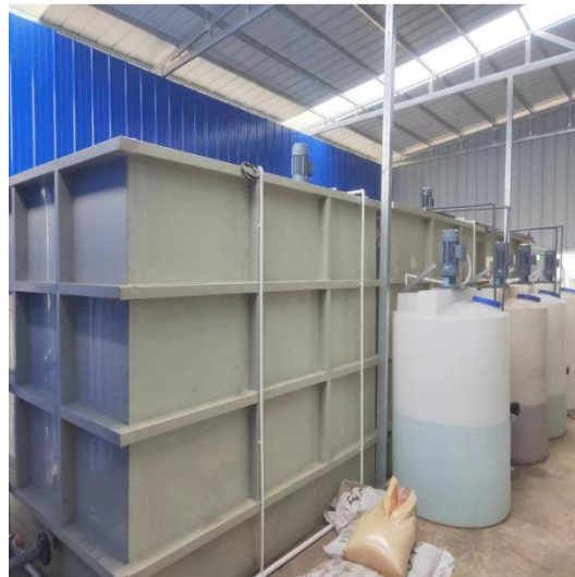
厂内自建污水处理站
