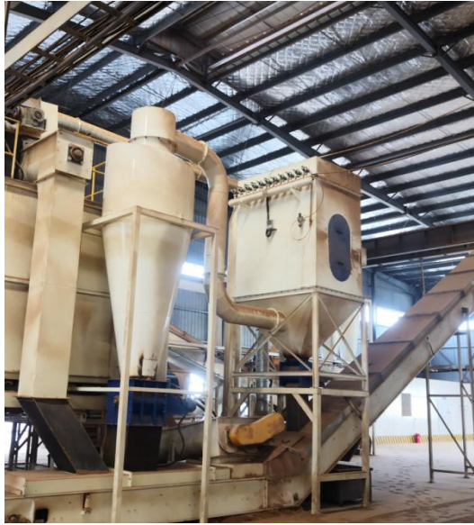
粉碎废气旋风除尘+布袋除尘装置
