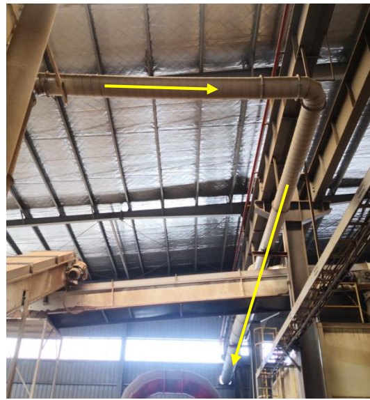
粉碎废气管道
