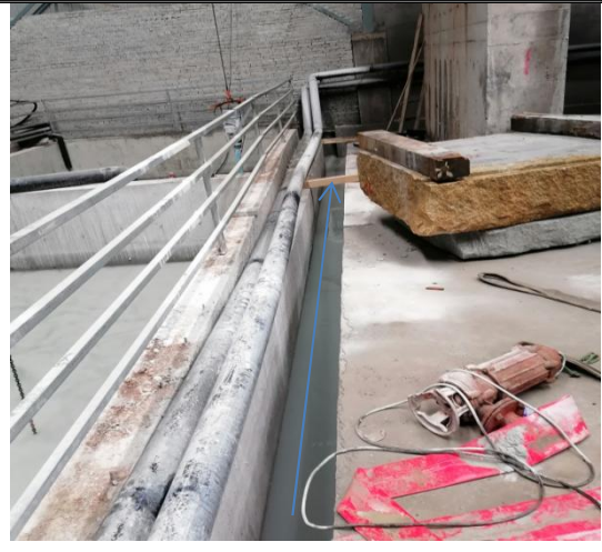
大切车间排水沟
