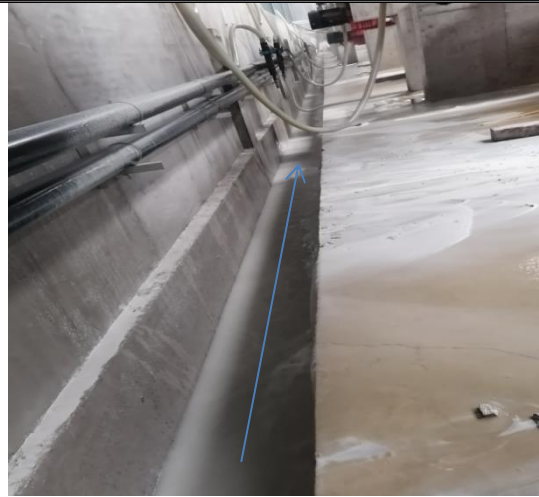
大切车间排水沟
