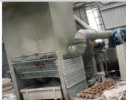
喷砂废气除尘装置
